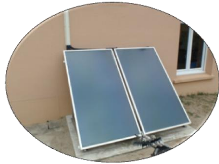
LES PANNEAUX SOLAIRES
